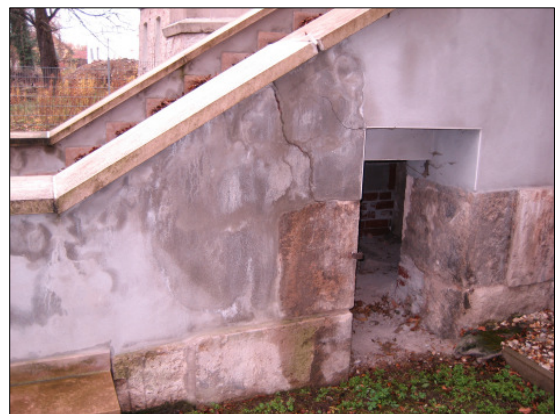
Rissbildungen im Treppenhaus
