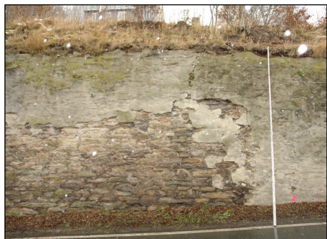
Geschädigter Bereich bei ca. Achse 0+060 (Abplatzung Spritzbeton)
