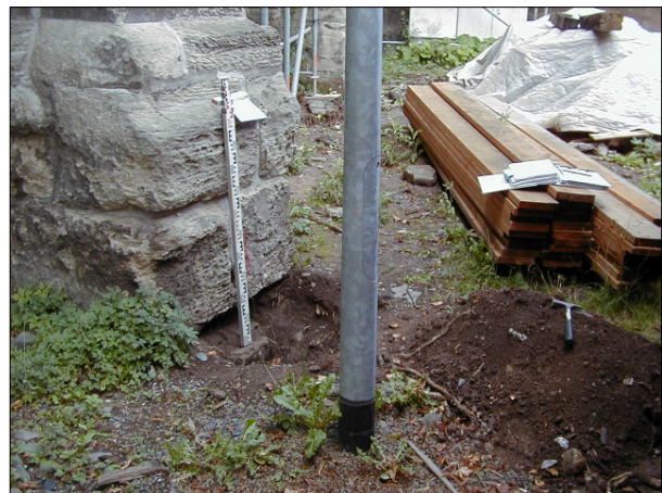
Schurf: Bereich Chor (kein Kraftschluss Fundament / Pfeiler)
