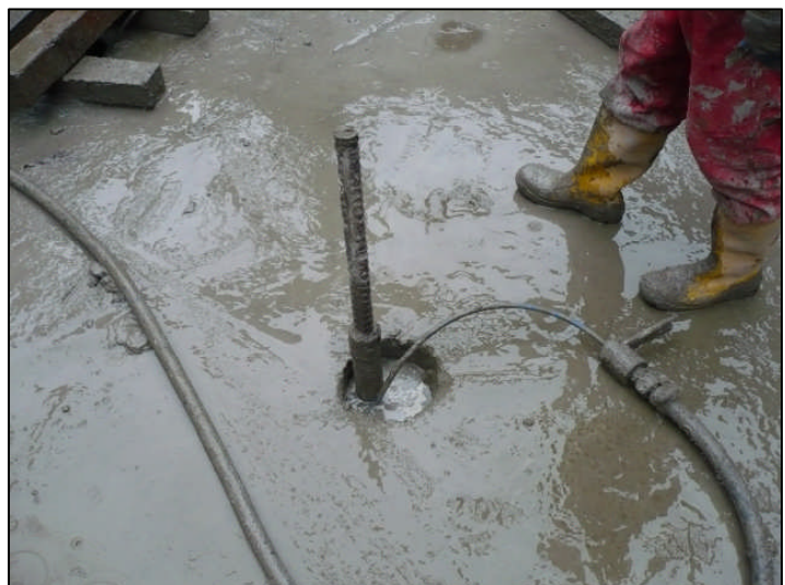
Gasaustritte im Grundwasser bei der Herstellung der Zugpfähle im RÜB
