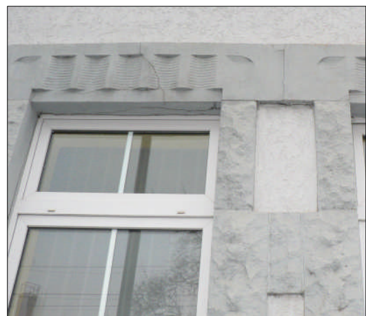
Detail: gut sichtbare Risse im Bereich des Fensterstures vor Baubeginn
