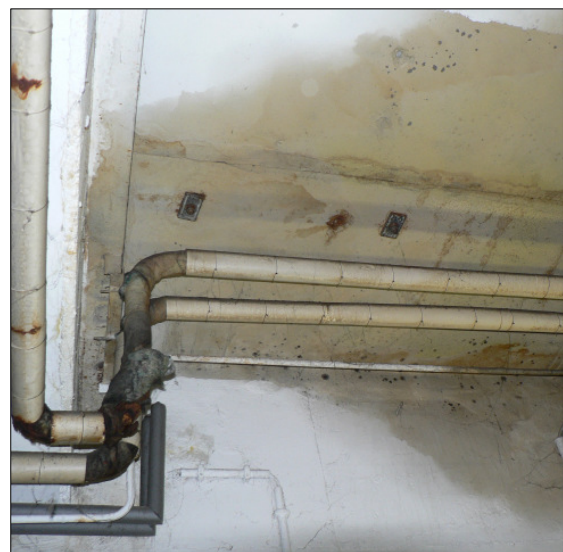
Kellerdecke nach Schadensfall mit Hydrauliköl
