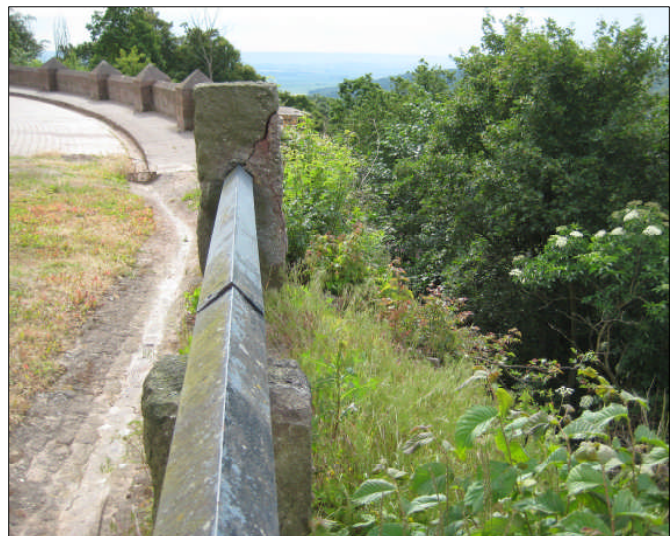
Sanierungsbedürftige Stützmauern im Bereich der Südumfahrung
